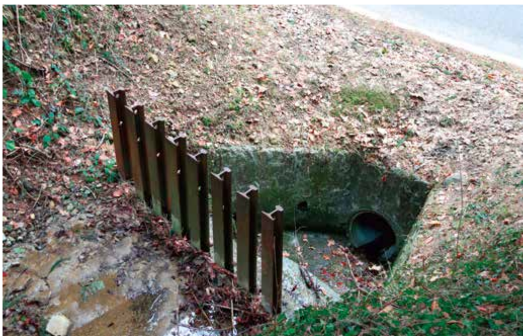
Fot. 214 (P. Pawlaczyk) Mały „łapacz rumoszu” przed przepustem pod drogą – dzięki niemu można swobodnie pozostawiać rumosz drzewny w strumieniu powyżej, bez obaw o zatkanie przepustu. Las Bregencki, Austria
