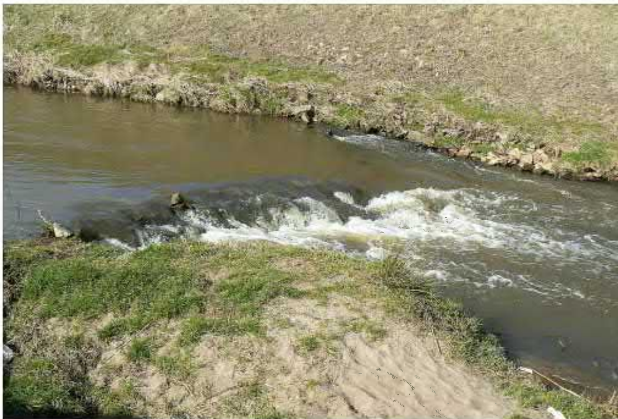
Foto. 17. Próg Legnica -Piątnica - widok erozji dennej poniżej progu
