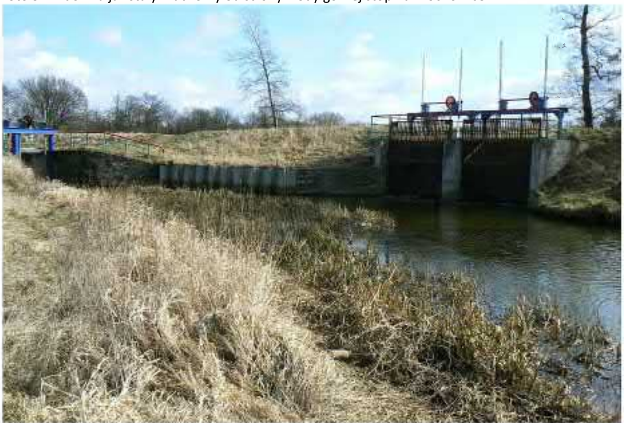
Foto.10. Widok stanowiska górnego stopnia Prochowice - kraty na wlocie do kanału młyńskiego
