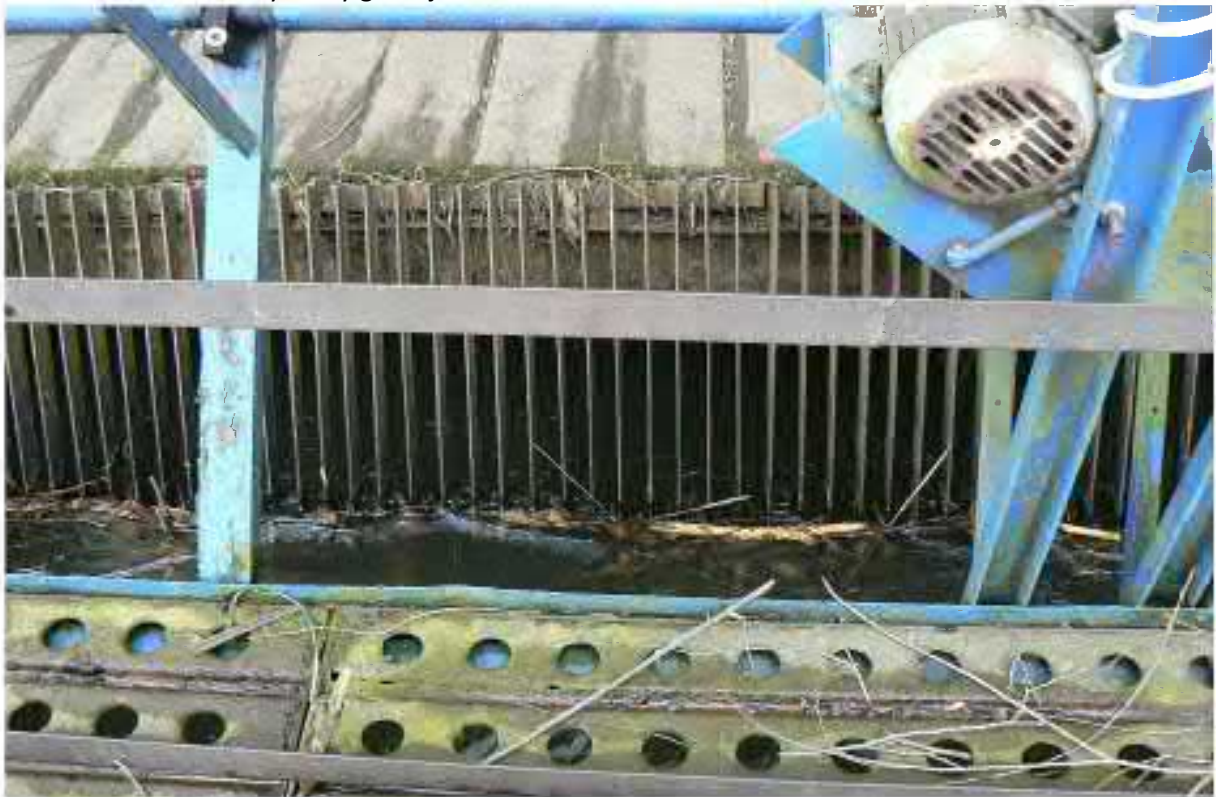
Foto.6. Widok krat zabezpieczających stanowisko górne MEW 2.
