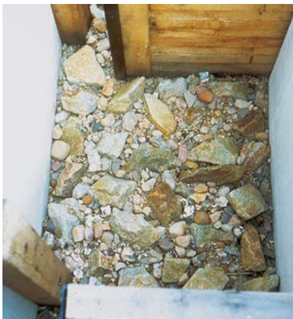
Ilustracja 3.14. Gruboziarnisty materiał żwirowy o różnej granulacji, pokrywający dno przepławki szczelinowej. Jaz Lower Puhlstrom (Unterspreewald/Brandenburgia)
