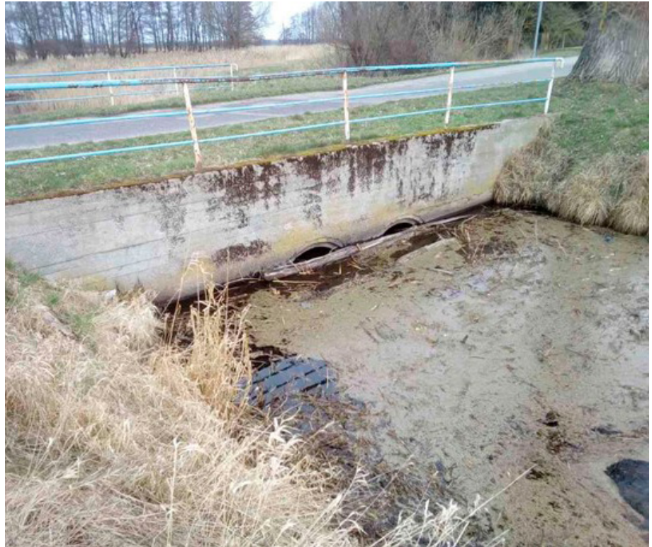
Fot. 7. Zatkany przepust na Niemicy – wymaga udrożnienia (przebudowy) zarówno ze względu na migrację ryb, jak i ryzyko powodziowe (fot. M. Świąć)
