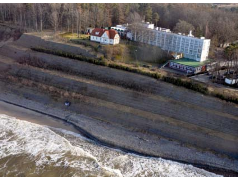
Najpotężniejsze umocnienie gabionowe brzegu morskiego w Polsce, Jastrzębia Góra, 2012 r., fot. © WWF/ D. Bógdał
