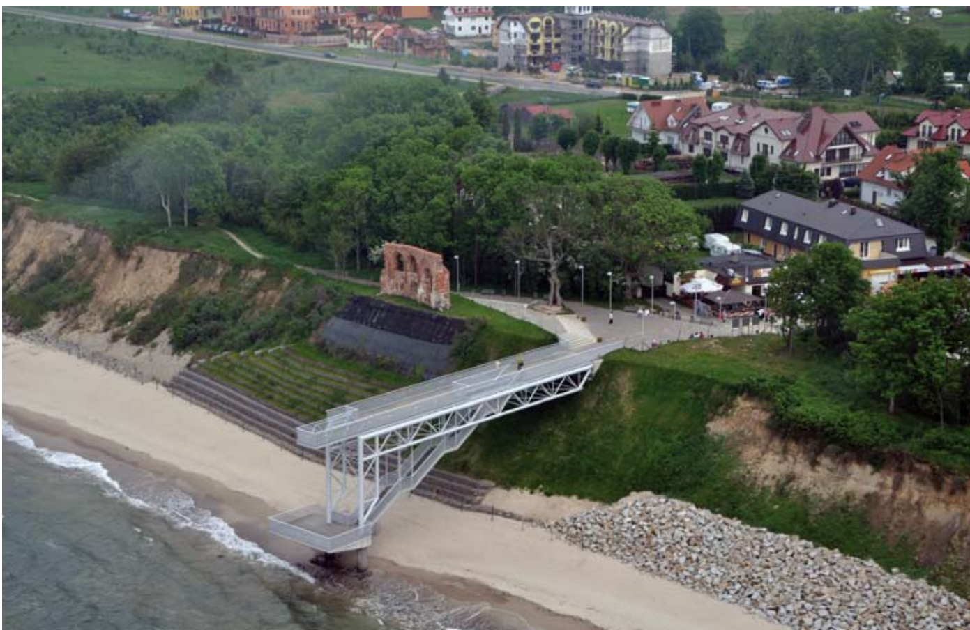
Umocnienia gabionowe i narzut kamienny w Trzęsaczu, 2010 r., fot. © WWF/ D. Bógdał
