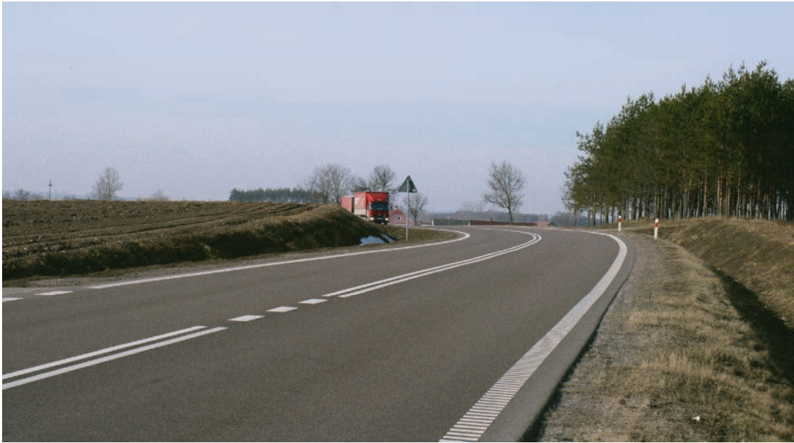
FOT. 2 DROGA NR 61 W POBLIŻU GUT. W TYM MIEJSCU WARUNKI TERENOWE POZWALAJĄ NA LOKALIZACJĘ DUŻEGO PRZEJŚCIA GÓRNEGO (fot. M. Dojlida)
